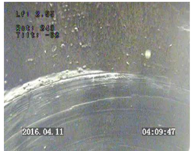
Prof 2.55 m : vue latérale / jonction entre deux buses en béton pleine / parois propres
