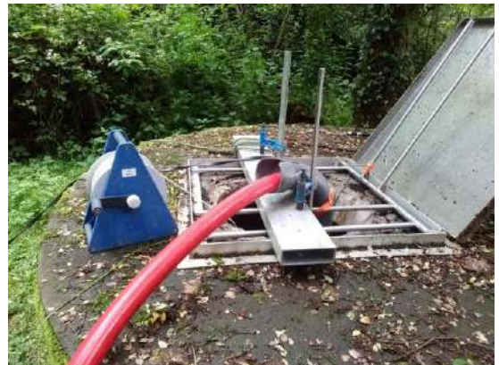
Sonde de niveau d'eau et tuyau d'exhaure
