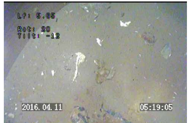
Prof 5.65 m : vision axiale sur le fond de l'ouvrage / présence de dépôt
