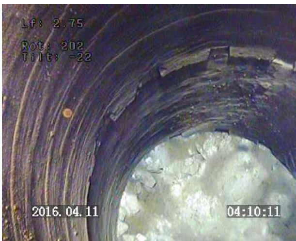
Prof 2.75 m : vision axiale / buses pleines en béton et buses avec des barbacanes / parois propres
