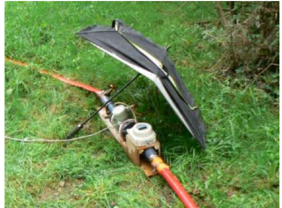
Débitmètre et vanne de réglage du débit
