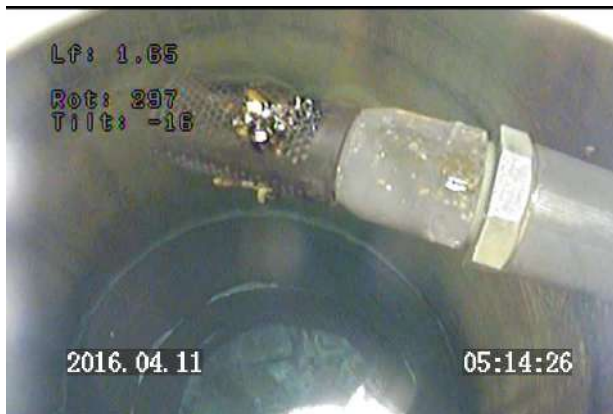
Prof 1.65 m : début de l'enregistrement / niveau piézométrique / prise d'eau avec crépines / buse pleine en béton
