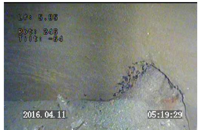
Prof 5.85 m : vue latérale au fond du puits / barbacane ouverte / parois propre
