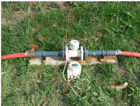
Débitmètre et vanne de réglage du débit
