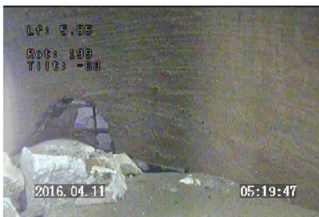
Prof 5.85 m : vue latérale au fond du puits / barbacane ouverte / parois propre
