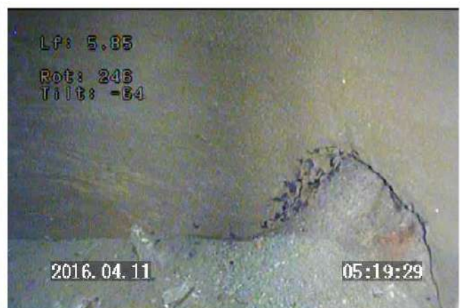
Prof 5.85 m : vue latérale au fond du puits / barbacane ouverte / parois propre
