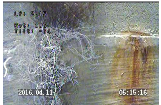
Prof 2.15 m : vue latérale / présence de racines entre deux jonctions de buse / buse pleine en béton
