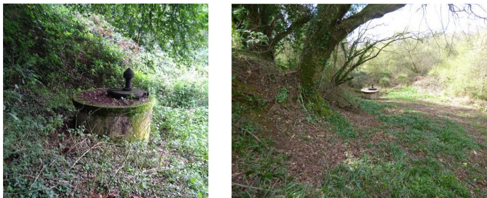
Figure 11 : Captage P3 dans son environnement proche (photo de droite Log Hydro)
