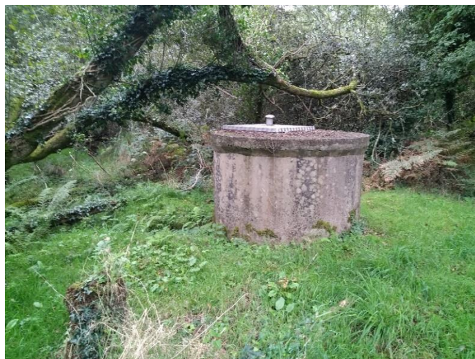
Figure 9 : Captage P1 dans son environnement proche
